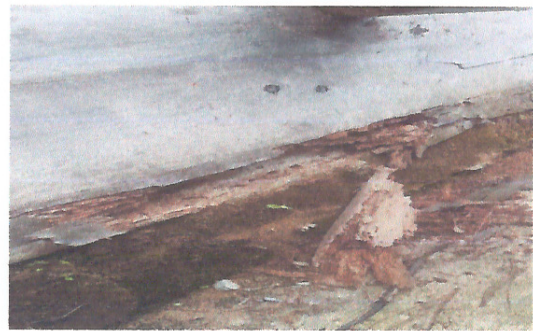
Foto 2: Pared de tabla en mal estado
