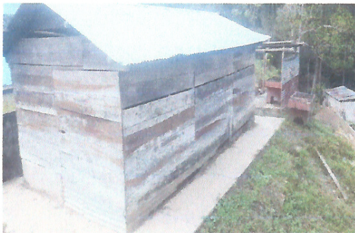
Foto 3: Cocina en mal estado sin ventilación
