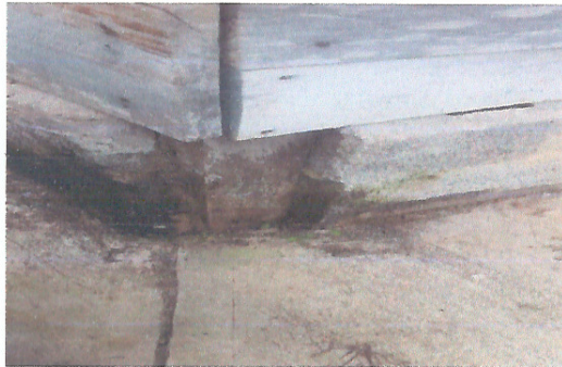
Foto 1: Horcones de la cocina deteriorados
